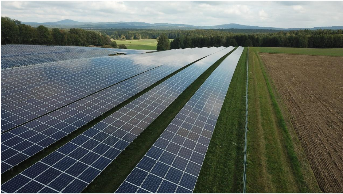
11. ábra - Fotovoltaikus panelek – Szabad felhasználású kép
