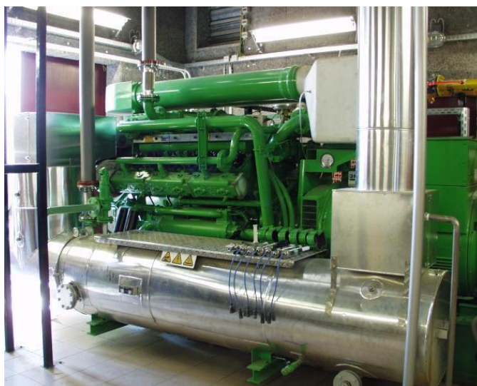
Figura 10. Motor de biogás
