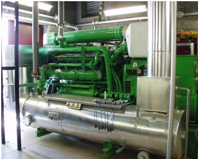
Figura 10 Impianto di biogas
